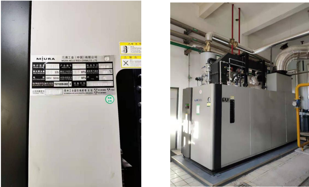
1#锅炉（低氮燃烧器）
