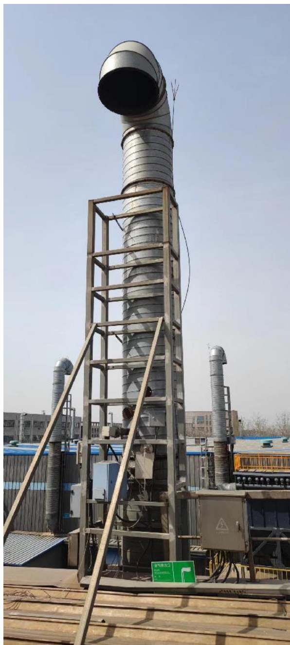
焊接排放筒 8 号 DA034(P14)
