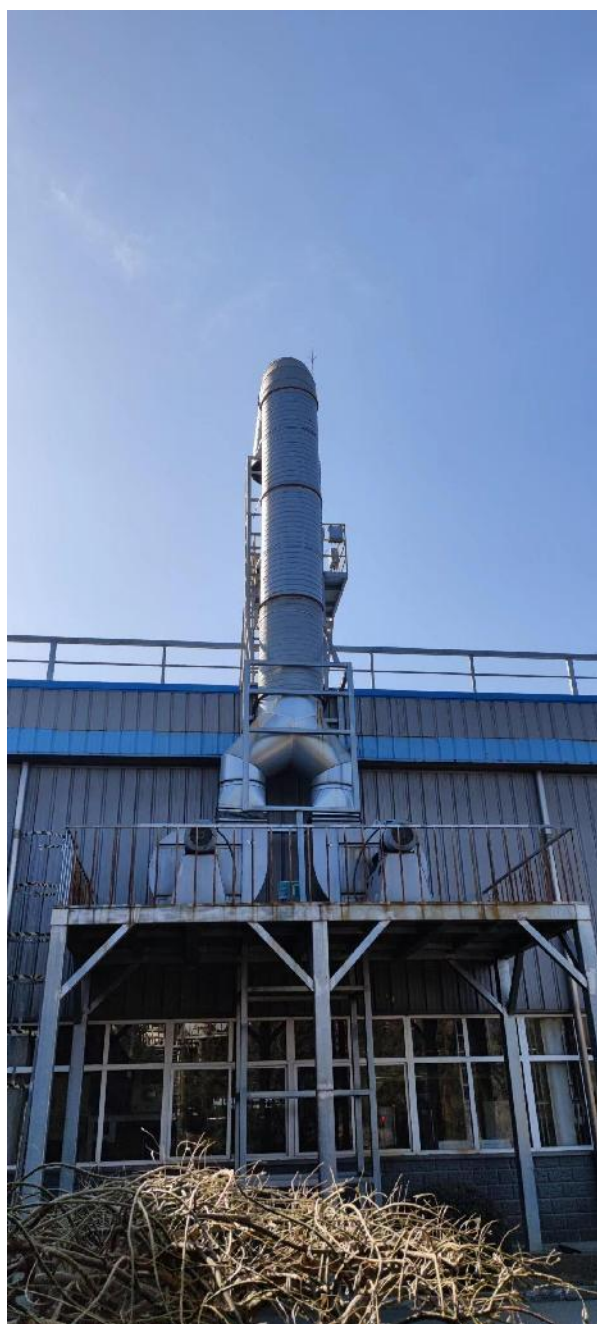
焊接排放筒 3 号 DA020(P7)
