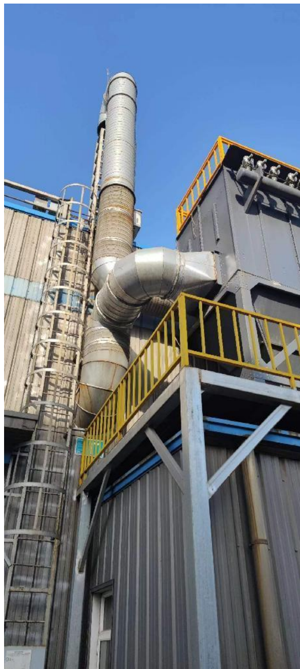
焊接排放筒 2 号 DA035(P6)
