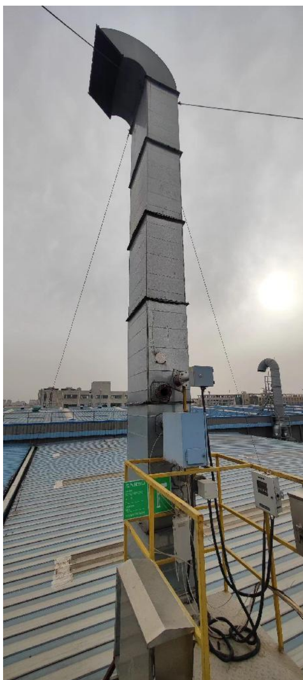
焊接排放筒 5 号 DA024(P9)
