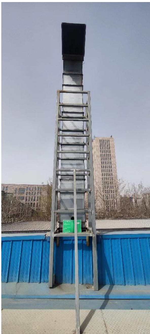
焊接排放筒 1 号 DA019(P1)
