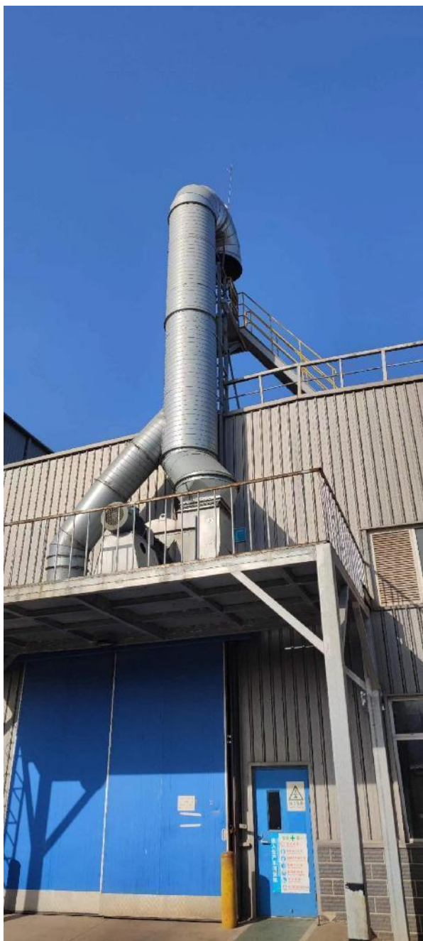
焊接排放筒 7 号 DA021(P13)
