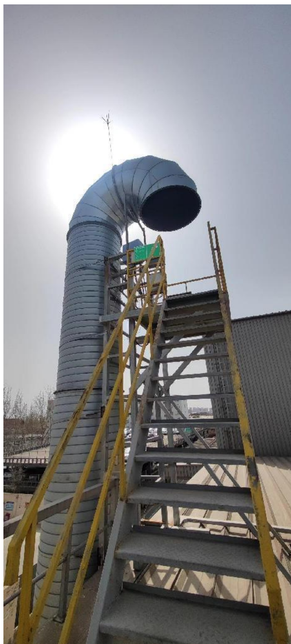
焊接排放筒 9 号 DA026(P15)
