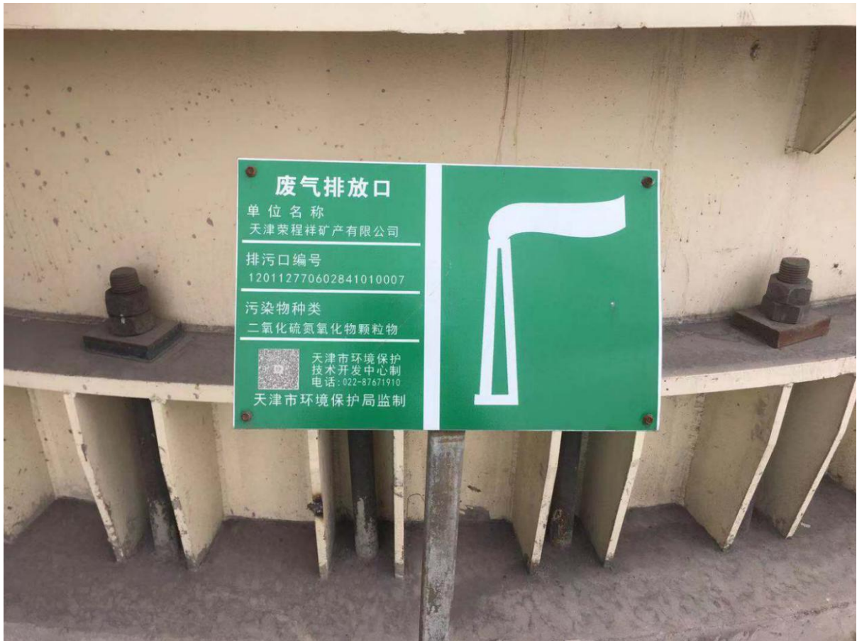
265m 2 烧结机废气排污口规范化
