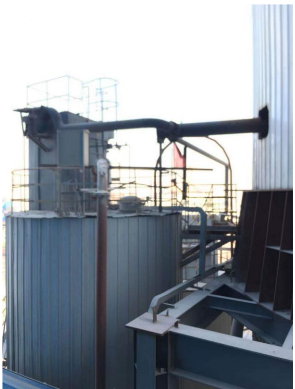
265m 2 烧结机脱硫原料仓回流装置
